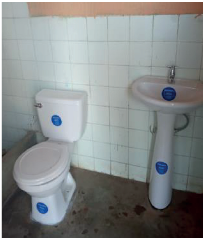
Sanitario y lavamanos en P/S Lagunas Cuaches, San Juan Ostuncalco
